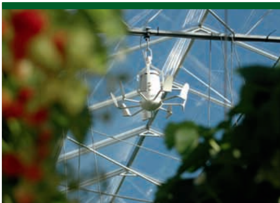
Op basis van verschillende koelsystemen op zijn bestaande bedrijf, koos Dings in zijn nieuwe kas voor een vernevelingsinstallatie en een aircobreeze.
